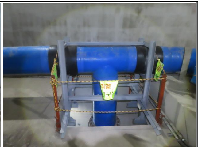
공중이용시설 3,4지 유입밸브실 난간 미설치
