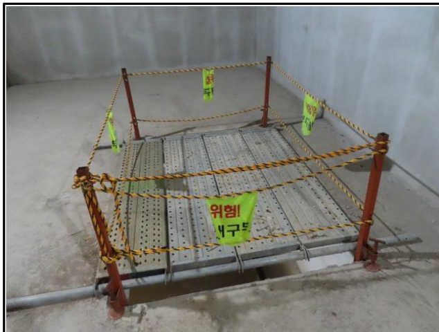
공중이용시설 1,2지 유입밸브실 난간 미설치
